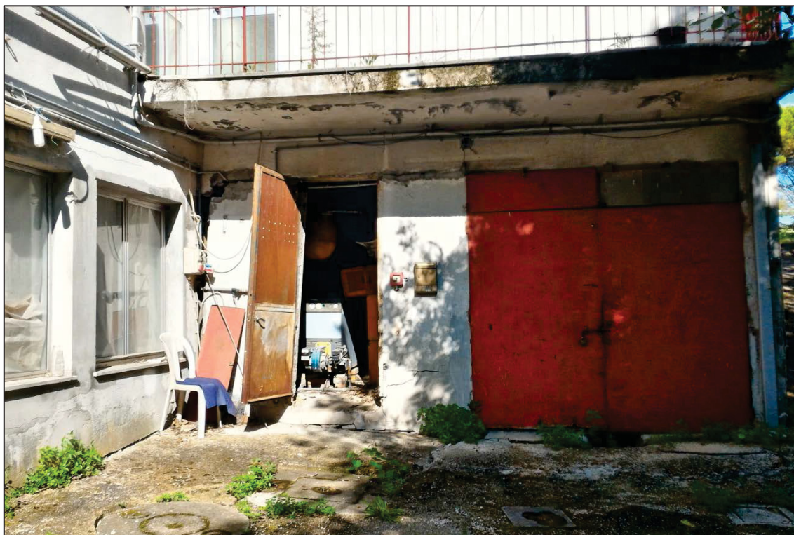
Figura 3.7: Cedimento con rotazione della parete di collegamento sul retro del corpo di fabbrica principale.
