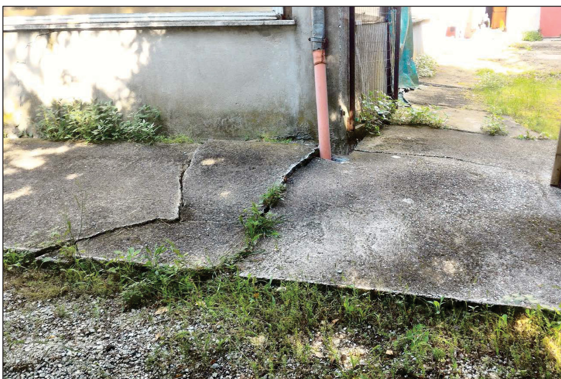
Figura 3.9: Cedimento del marciapiede sullo spigolo destro del lato di valle dell'edificio.
